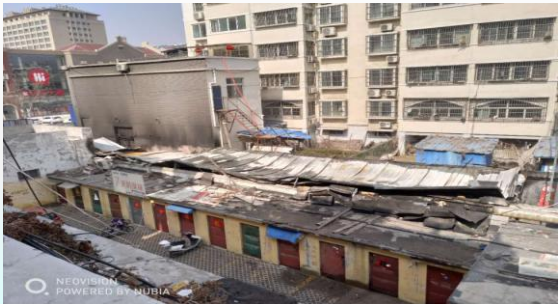
山东枣庄“2·19”事故现场
