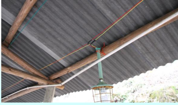
电气线路裸露敷设
